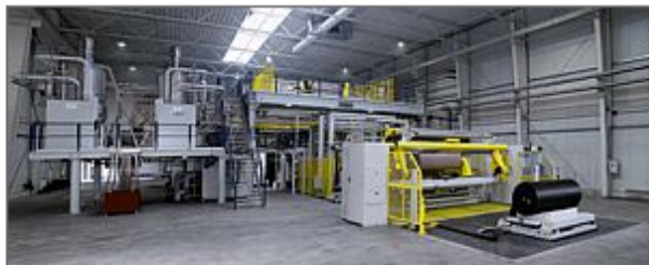
Die neue Beschichtungsanlage in Nordkirchen (Foto: CaPlast)
