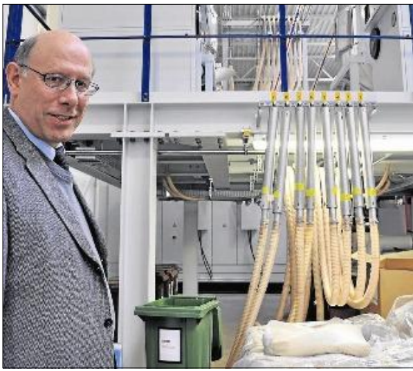
Caplast-Geschäftsführer Josef Altepping vor dem Lager für die Rohstoffe der Beschichtungen. Demnächst sollen die Rohstoffe in Silos vor der Halle lagern. RN-Foto Glöckner
